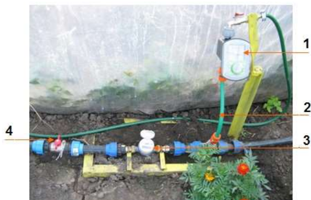
Fig. 27 Sistemul automat de programare a udării: 1 – programator irigații; 2 – furtun soluție fertilizantă; 3 – contor de apă; 4 – robinet trecere.
